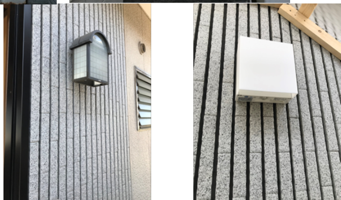
外照明 停電時に点灯
